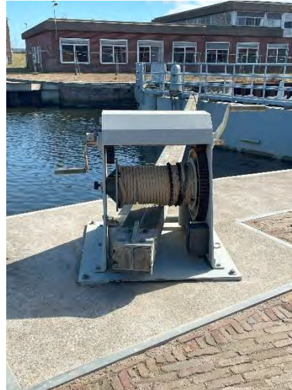
Figuur 13. Aandrijving Boerenverdrietsluis.
